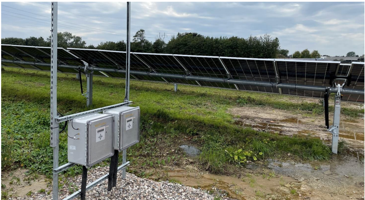
Figur 9: Eksempel på tekniske installationer mellem panelerne.
